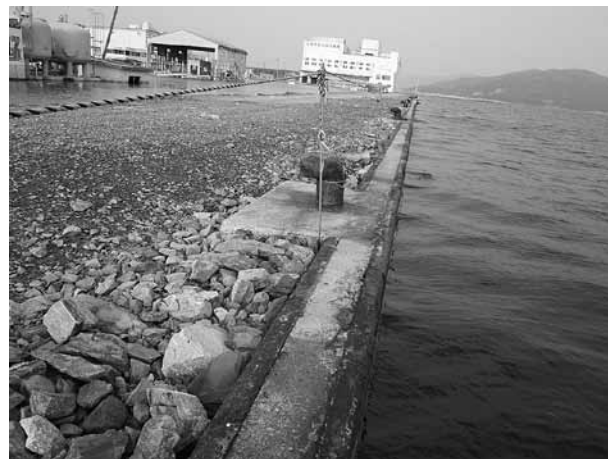
70～80cm地盤沈下した石巻工業港（5月24日から県によるかさ上げ工事がはじまりましたが…）
