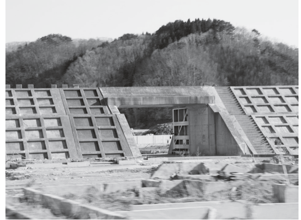
津波が乗り越えた宮古市田老の防潮堤（2011年4月20日）
