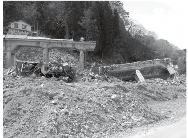
倒壊した三陸鉄道鳥越（しまのこし）駅付近の高架橋（2011年4月3日）
